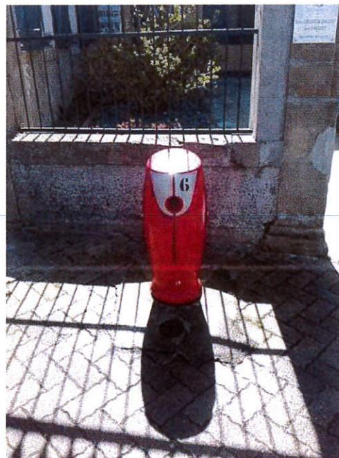
Photo de l'hydrant
