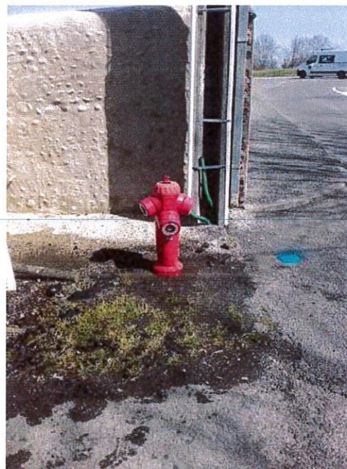
Photo de l'hydrant
