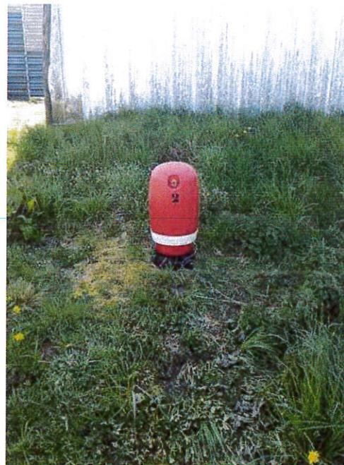
Photo de l'hydrant
