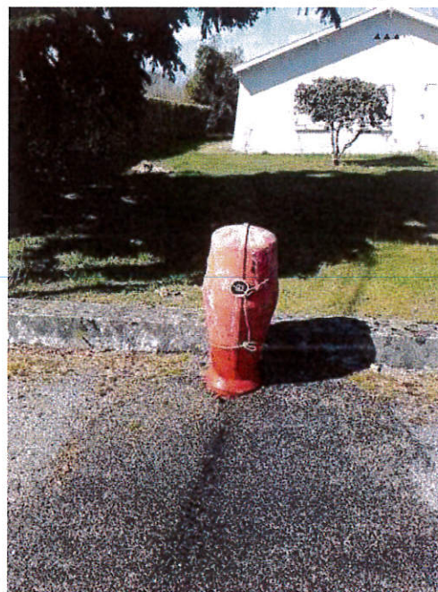
Photo de l'hydrant
