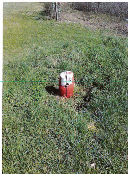
Photo de l'hydrant
