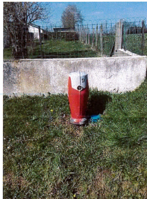
Photo de l'hydrant
