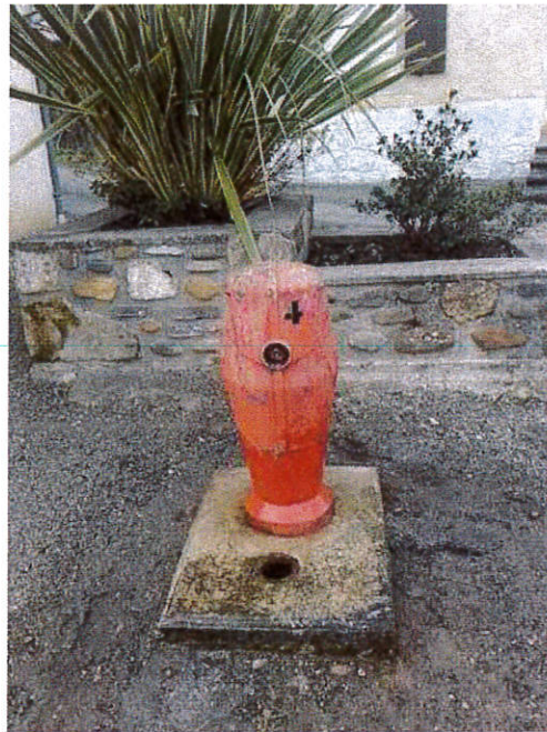
Photo de l'hydrant
