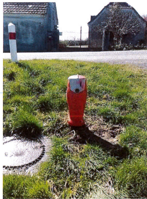
Photo de l'hydrant
