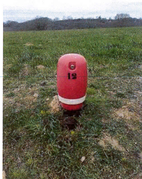
Photo de l'hydrant
